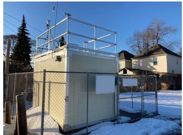
Estación de monitoreo del aire
