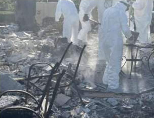
照片中，工作人员在周围弥漫灰烬的灾区； 照片是在涂抹 soiltac 之前拍摄的。
